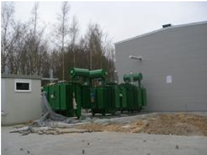
Bild: Ölgekühlte Trafo und Hochspannungsgleichrichter mit 10 kV-Stationsgebäude
